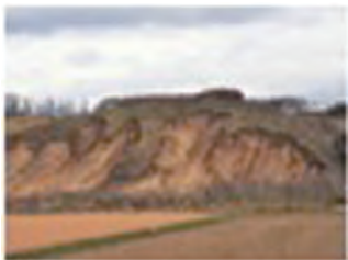
斜面崩壊現場例
